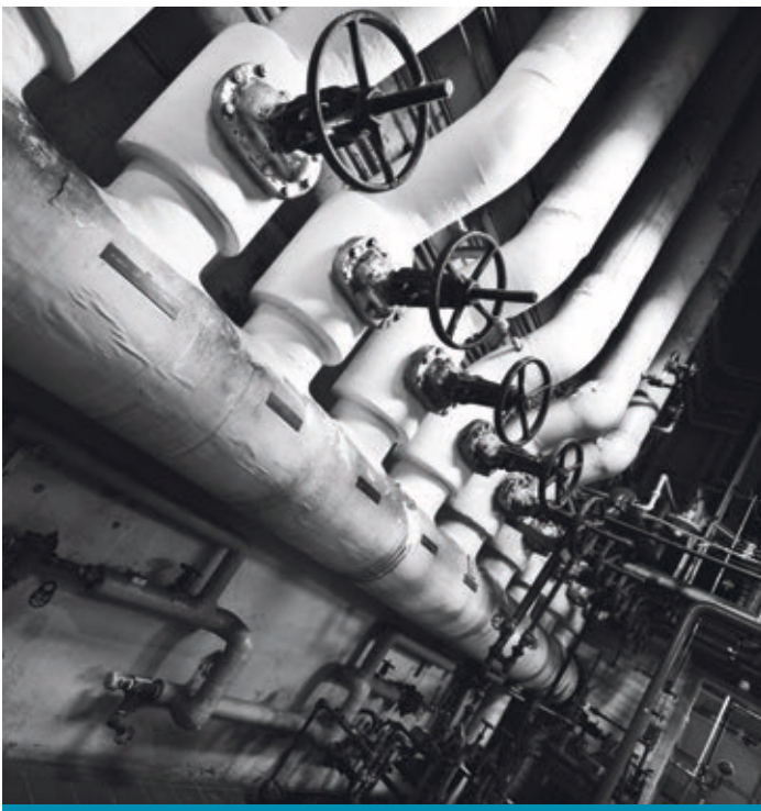
La chaufferie, qui est située au sous-sol de l'HME.
